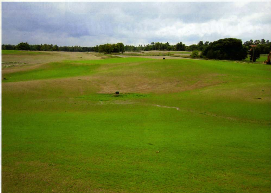
De olika momenten är nu gjorda på hål 5 och 8. Vad som skett är grov schakt, fin shaping, gräva för ytvattenbrunnar och ledningssystemet, utläggning av sand (sandcapping), box blading, invattning och sådd. Snart dags för första klipningen. Vesterby Golf, Linköping. (Arkitekt Johan Benestam, 2005)
